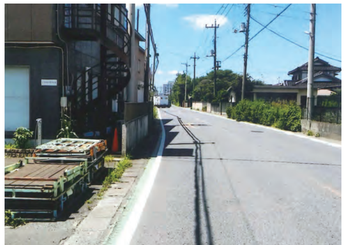
根金交差点～市道13号線交差点区間 歩車道境界ブロックがない箇所
